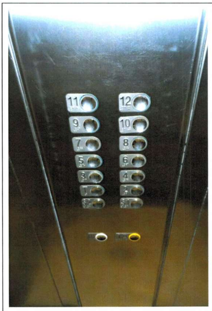
Foto 17 - Detalhe do painel do elevador e distribuição de pavimentos.
