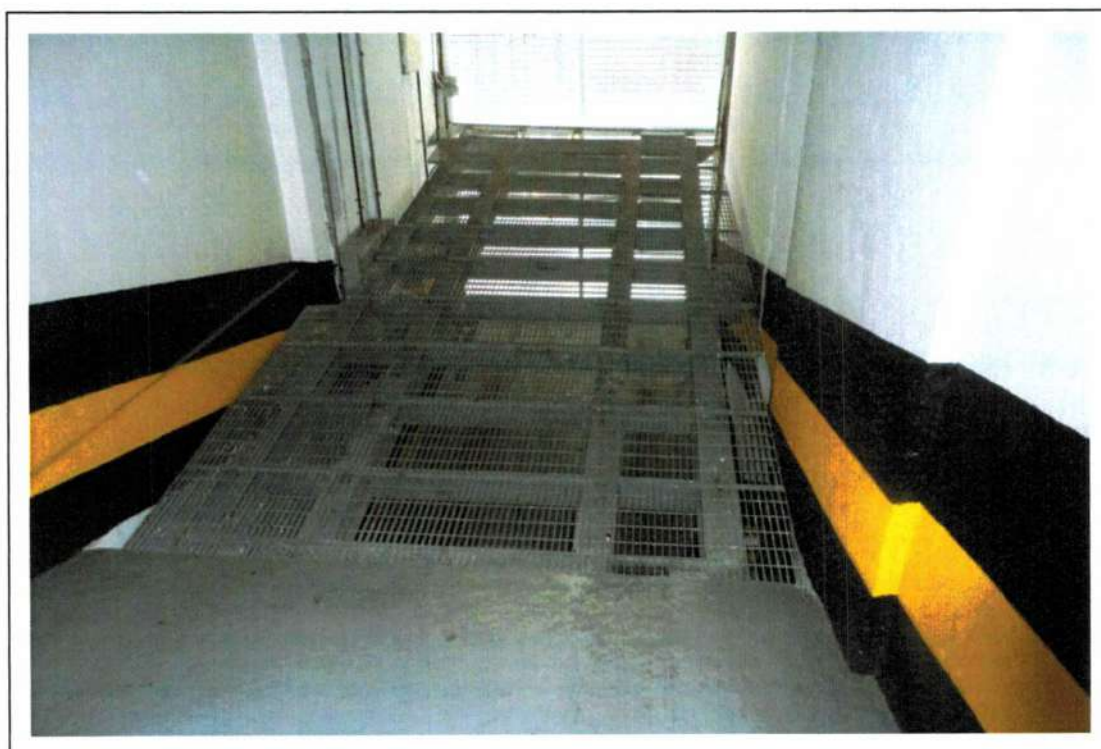
Foto 13 - Elevador para acesso às áreas de estacionamento.
