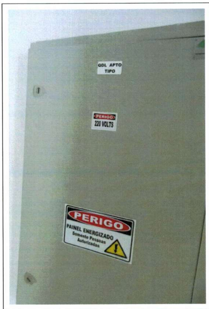
Foto 34 - Quadro de distribuição de luz da unidade.
